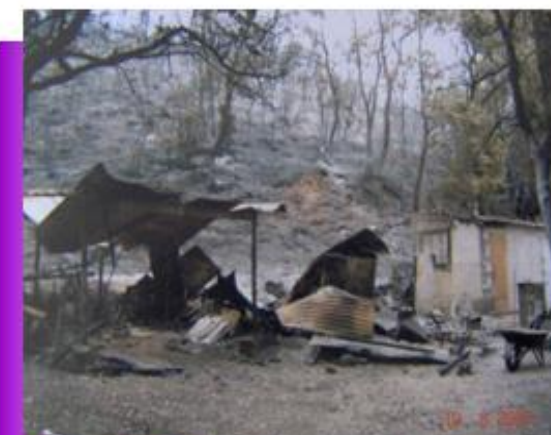
Dégâts sur une installation Extérieure/dépendances
