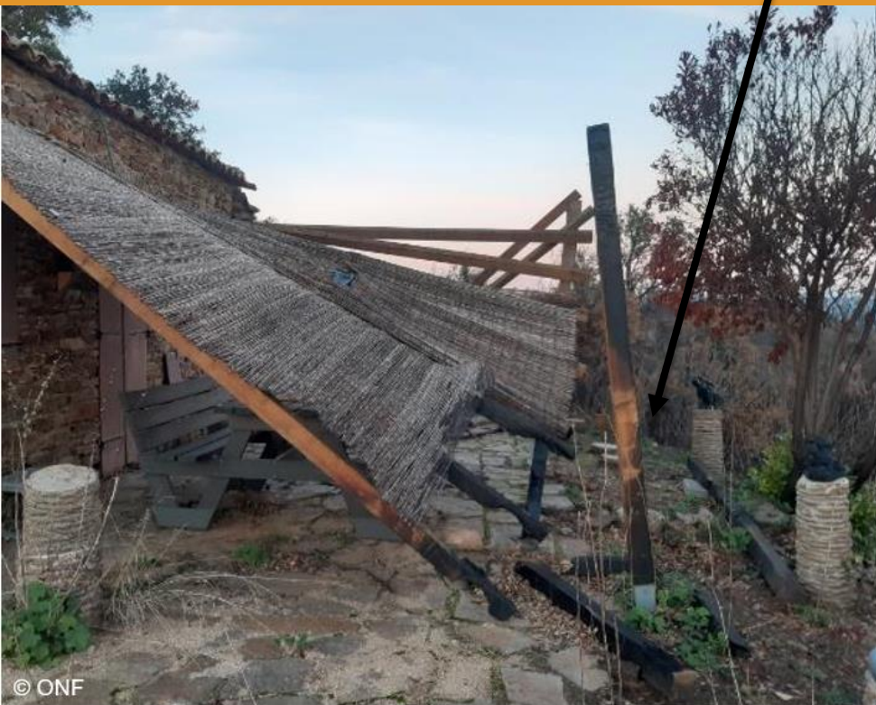
Auvent en bois partiellement brûlé sans propagation à la maison
