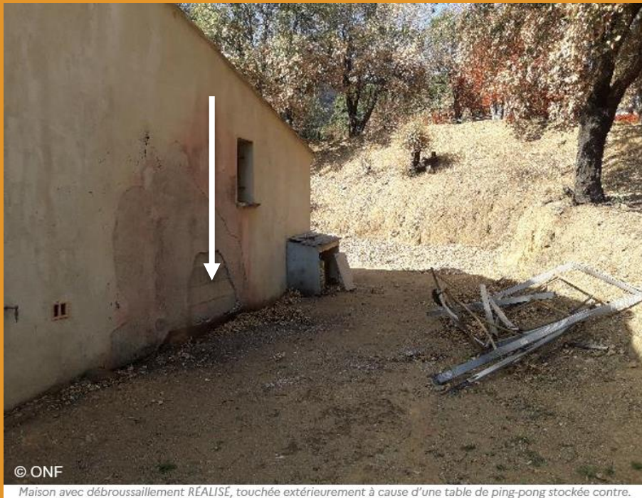
Maison avec débroussaillage RÉALISE, touchée extérieurement à cause d'une table de ping-pong stockée contre.
