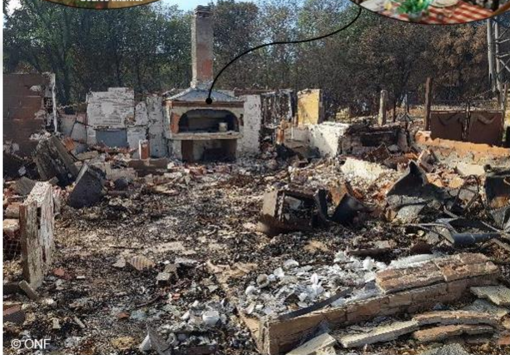
© ONF Éléments extérieurs en bois dont la combustion a propagé le feu à l'intérieur du restaurant (facteur ayant aggravé un débroussaillage NON RÉALISÉ)
