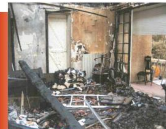
Construction touchée intérieurement
