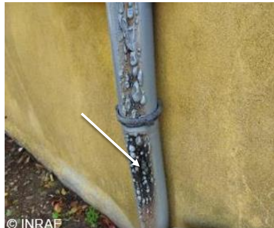
© INRAE Gouttière en zinc
