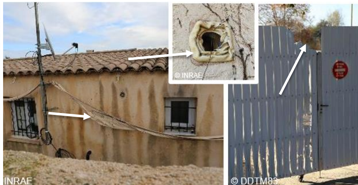
© INRAE © DDTM83 Eléments en PVC fondus (gouttière, portail, bouche aération)
