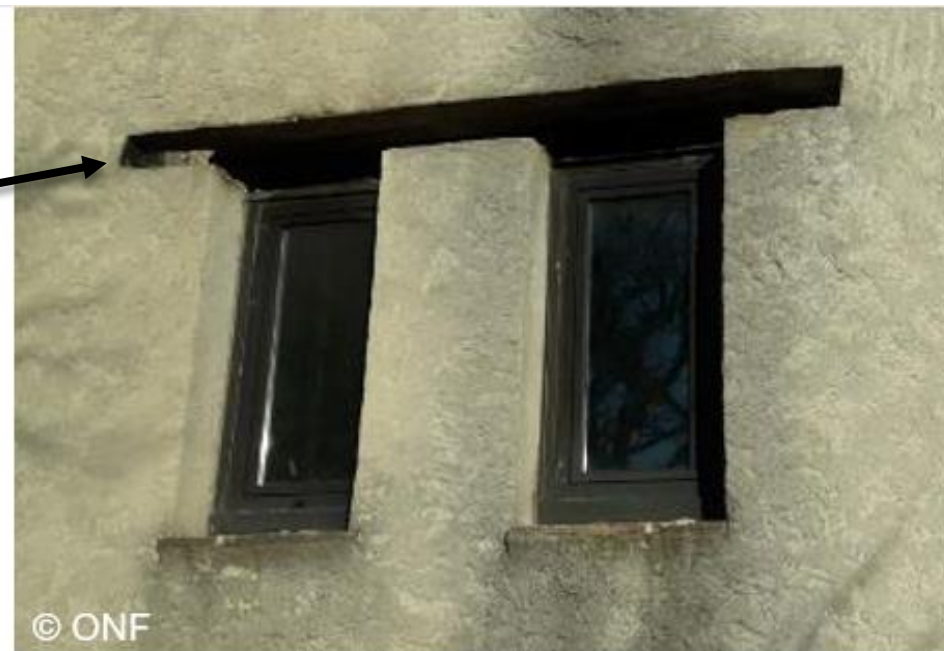
Linteaux en bois apparents dont la combustion est une des hypothèses d'entrée du feu dans la maison
