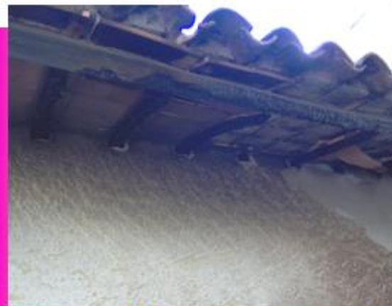
Construction touchée extérieurement
